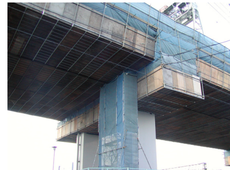
名古屋高速道路 万場線 九重 橋脚用足場
